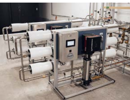
Die neue Osmose-Anlage der ZWZ ermöglicht eine verbesserte Aufbereitung des Speisewassers.
